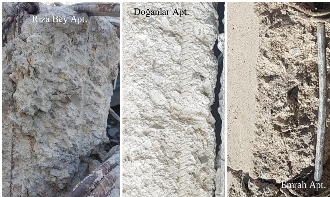
Şekil 3.55 – Yıkılan bazı binalarda gözlenen beton kalitesi
