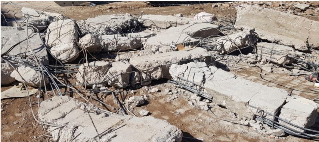
Şekil 3.24 – Emrah Apartmanı'nındaki hasarlı yapısal elemanları
