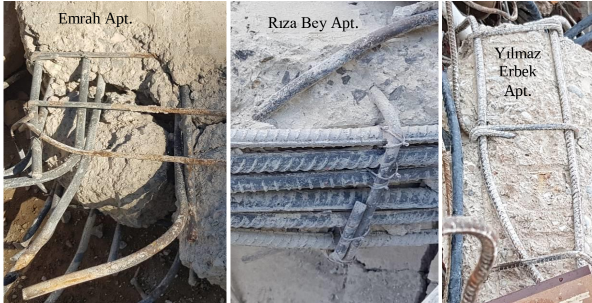
Şekil 3.57 – Yıkılan bazı binalara ait donatı detayları
