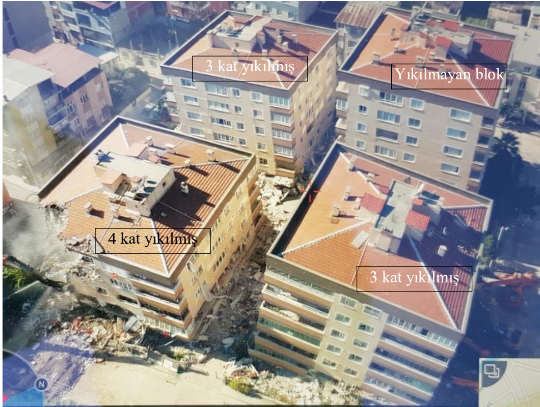
Şekil 3.43 – Barış Sitesi enkazı (uçangöz görünümü)
