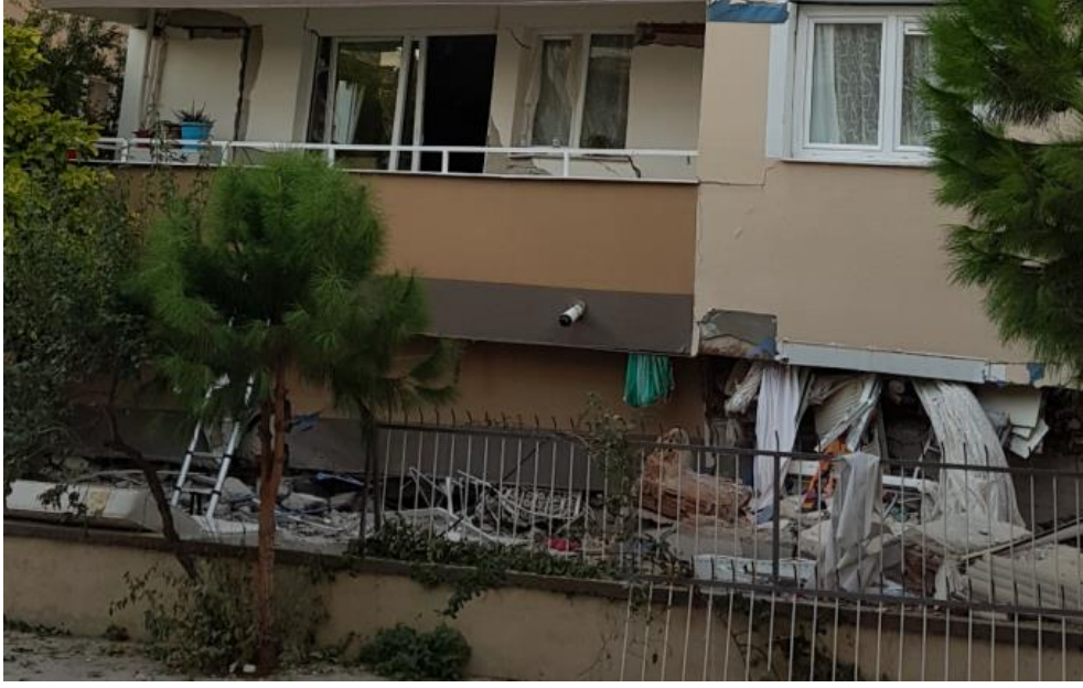
Şekil 3.48 – Barış Sitesi enkazı (arka görünüm)
