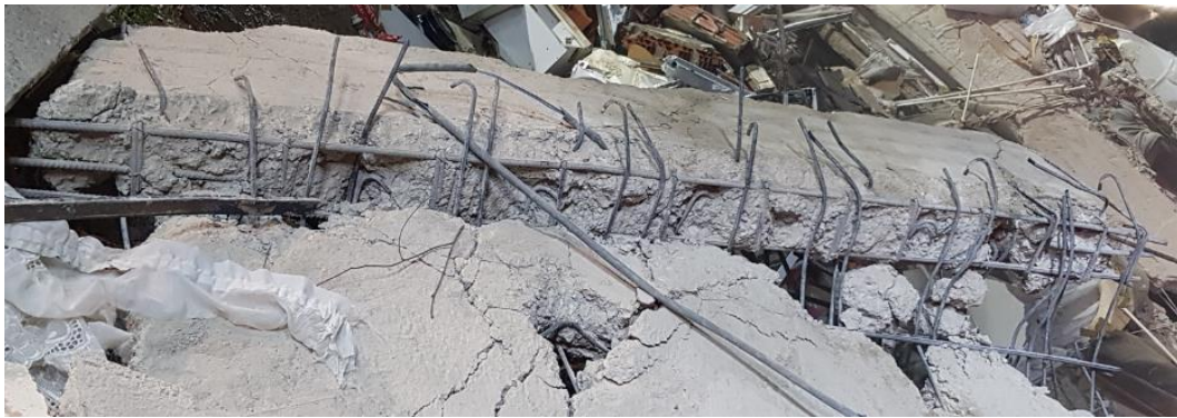
Şekil 3.18 – Doğanlar Apartmanı’nın bir kolonu
