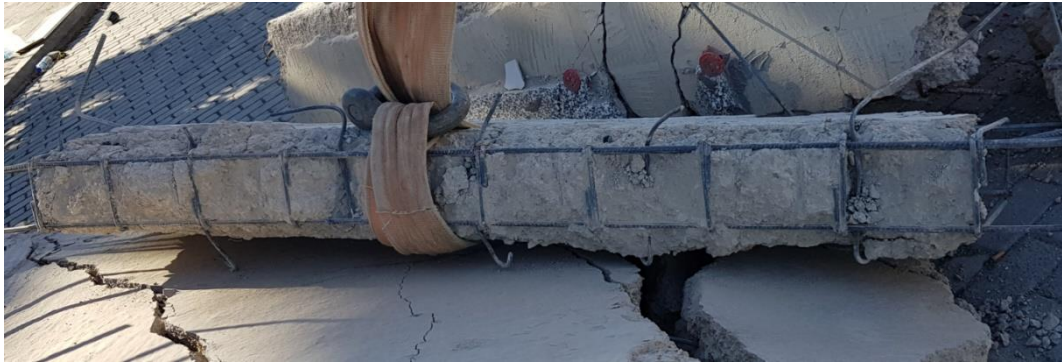
Şekil 3.11 – Rıza Bey Apartmanı'nda hasar görmüş bir kolon
