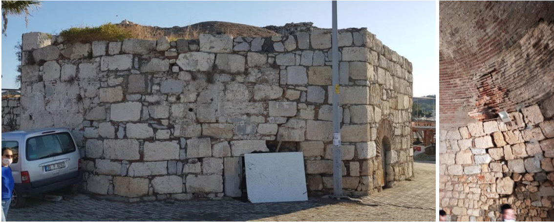
Şekil 5.9 – Tarihi kubbe yapısı ve iç kısmındaki dökülmeler
