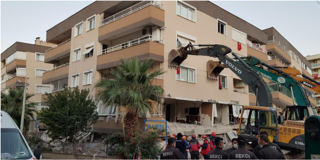
Şekil 3.46 – Barış Sitesi enkazı (çapraz görünüm)
