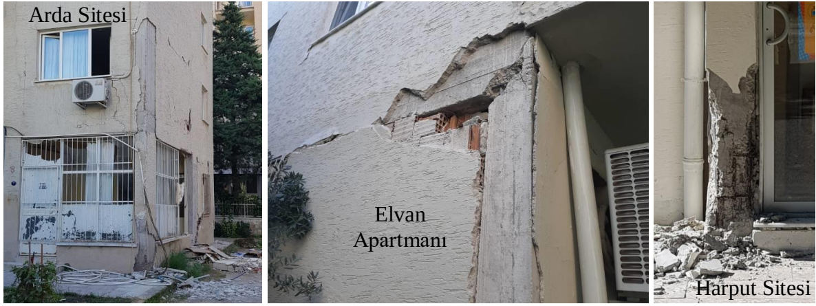
Şekil 3.53 – Ağır kolon hasarları
